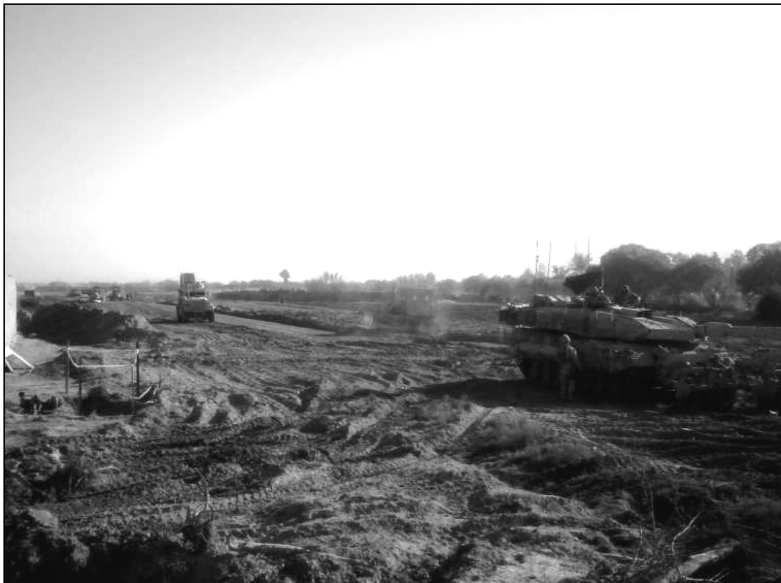
Chars d'assauts de l'Escadron avec les rouleaux de déminage, en support aux ingénieurs américains sur le chantier de la route. (Photo par le capt P. Croteau)
